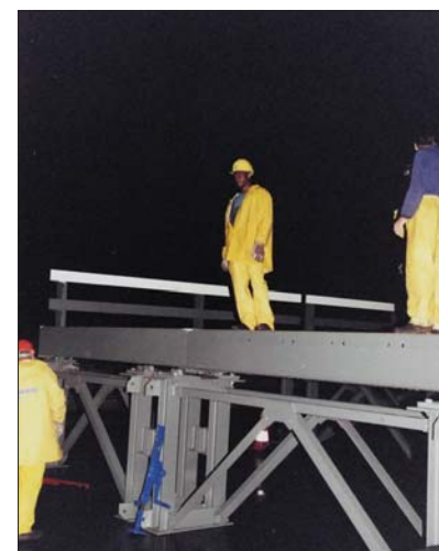
Bild 12. Die ersten Böcke und Fahrbahnelemente inklusive Leitschienen sind montiert Fig. 12. The first trestles and deck elements including crash barriers are installed
